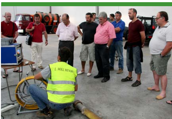
Prácticas de saneamiento de red de alcantarillado en el marco del curso sobre detección de fugas y mejora de las redes municipales de abastecimiento
